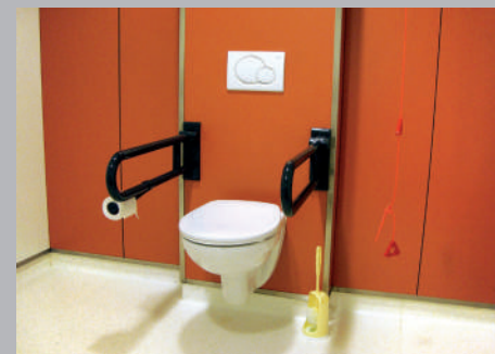
✓ Toilette adaptée disposant de 2 aires de transfert
