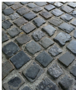
✗ Pavés bombés avec joints creux
