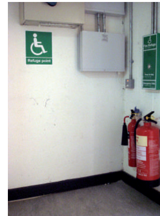
✓ Extincteur placé à bonne hauteur
