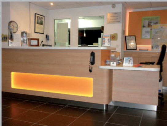
✗ Tablette surbaissée trop peu profonde
