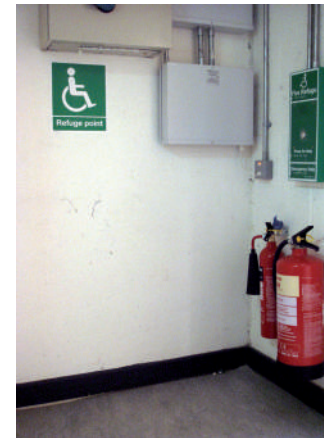
✓ Brandblusapparaat aangebracht op de juiste hoogte
