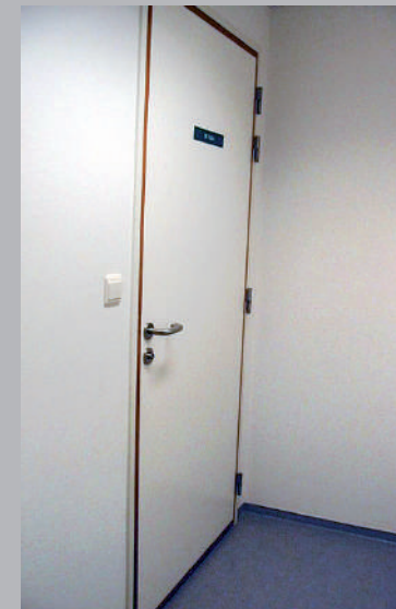
✗ MWanden, vloeren en deuren vertonen onvoldoende kleurcontrasten
