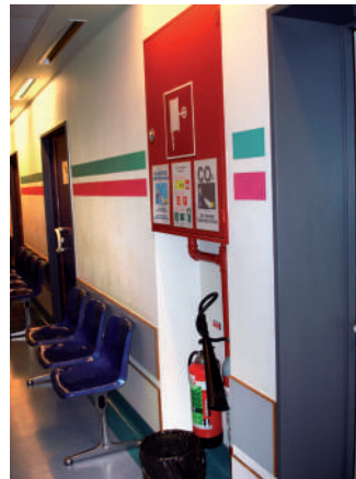
✓ Brandblusapparaat aangebracht in een nis
